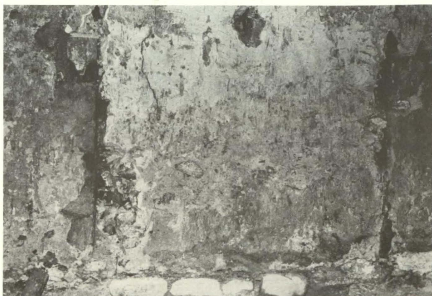
Fig. 3 — Restos da grande chaminé
